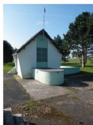
Captage AEP Puits 2 de Gueux
